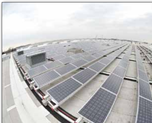
Zonnepanelen op veilingloods
